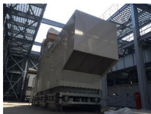
非常用発電機
