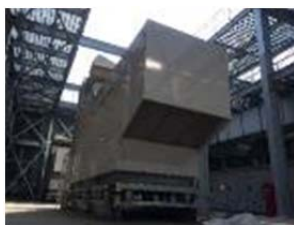
非常用発電機
