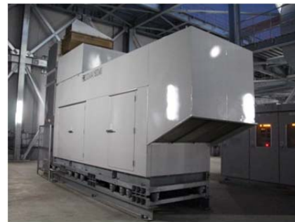
稼働中の非常用発電機
