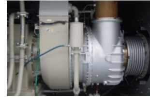
非常用発電設備
